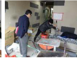
東側エントランス 手動ポンプの動作確認
