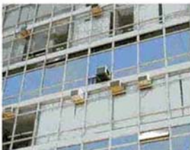
■写真3—近代的な試みである中央省庁のカーテンウォールには空調設備がはみ出ている
